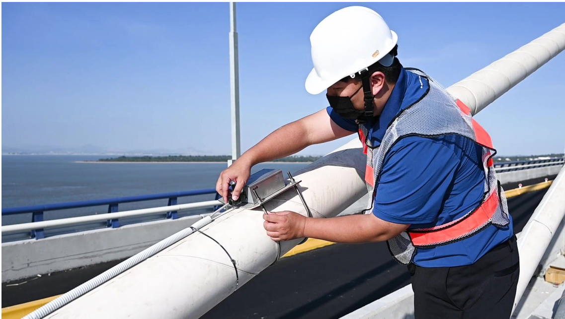
三聯科技為金門大橋進行結構健康監測系統 (SHM)。
